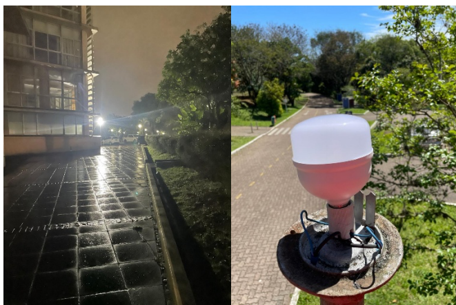
Legenda: Troca de refletores no prédio 4 e verificação o acendimento automático
